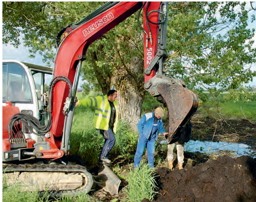
Für die Anlage eines Stillgewässers sind zunächst hydrogeologische Voruntersuchungen auf der Maßnahmenfläche durchzuführen.
